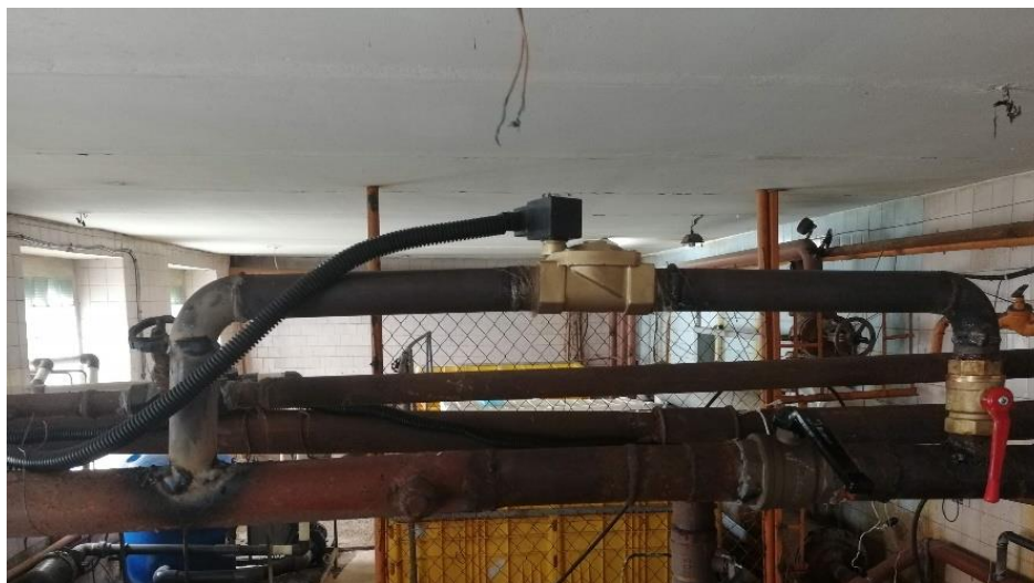
Рисунок 3 – Внешний вид установленного электромагнитного клапана
