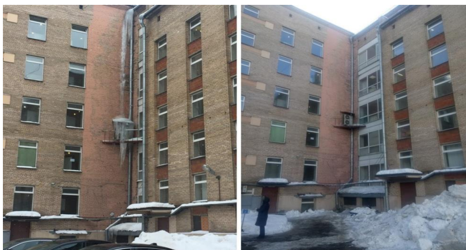
Рисунок 4 - Удаление гигантской наледи с фасада здания [11]
