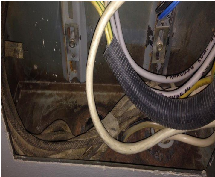
Рисунок 5 - Наведение порядка в щите электроснабжения [11]
